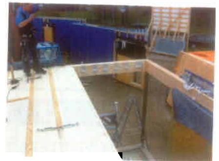
Bild 8: Die Geschossdecke wurde an den Randunterzug ebenengleich durch Stahl Z-Profile mit einer Lagesicherung durch Simplexverbinder angeschlossen.
